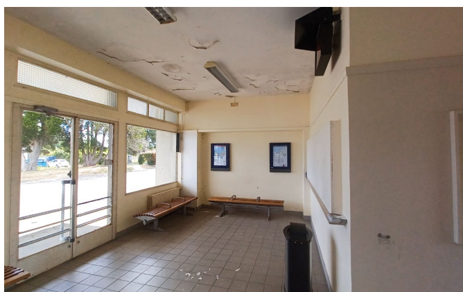
Salle d'attente et son plafond dégradé
