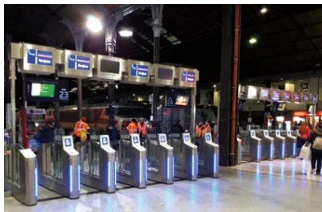
Les portiques installés en gare de Paris Saint-Lazare.
